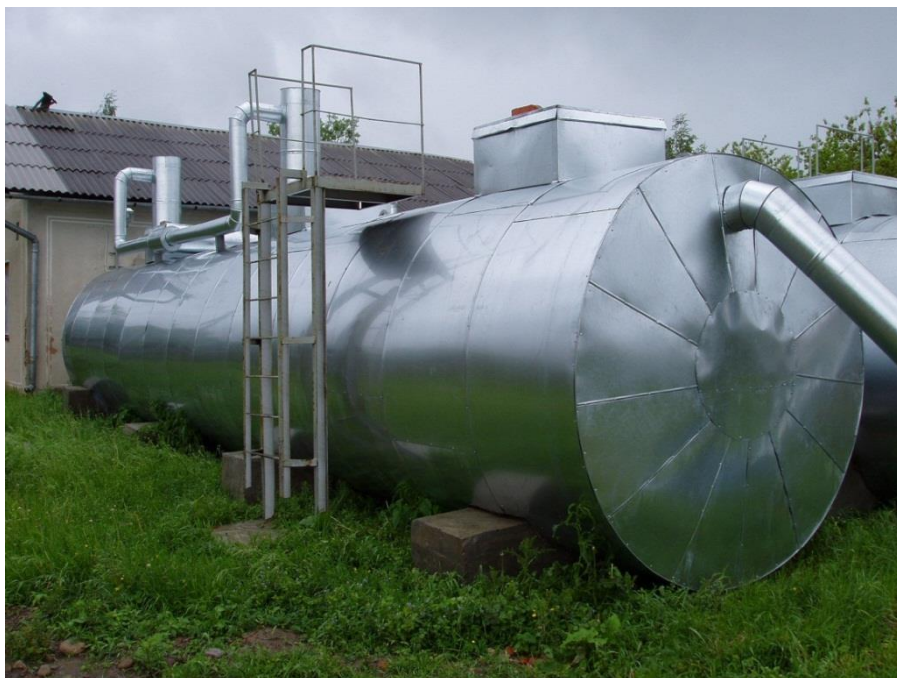
Рис. 5. Компактні установки у складі очисних споруд районної лікарні
