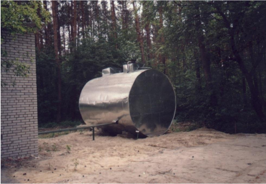
Рис. 6. Очисні споруди місії Карітас в селищі Зарічне
