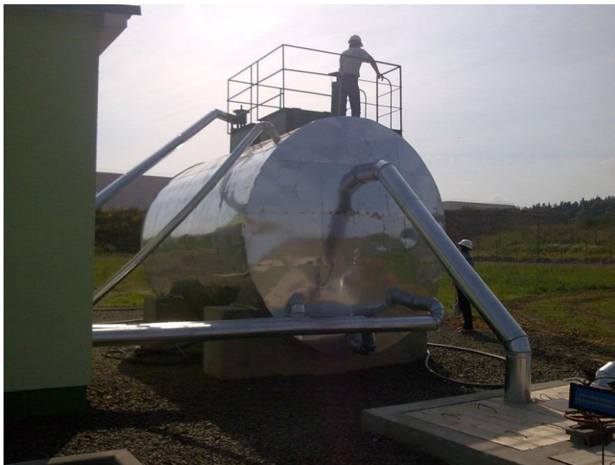
Рис. 8. Компактна установка у складі очисних споруд господарсько-побутових стічних вод фабрики по виробництву харчових концентратів
