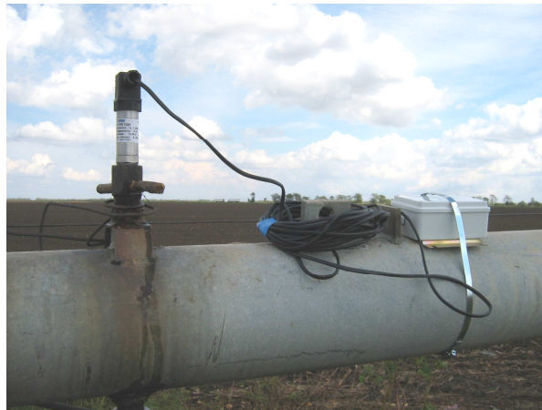
Рис. 11. Реєстратор тиску на трубопроводі ДМ «Фрегат»
