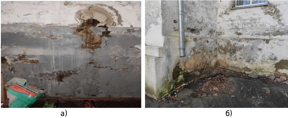
Рис. 1. Фото стін навколофундаментної зони: а) протікання кліматичної вологи крізь стіни підвалу; б) замокання цокольної частини стіни внаслідок руйнування системи водовідведення та вимощення
