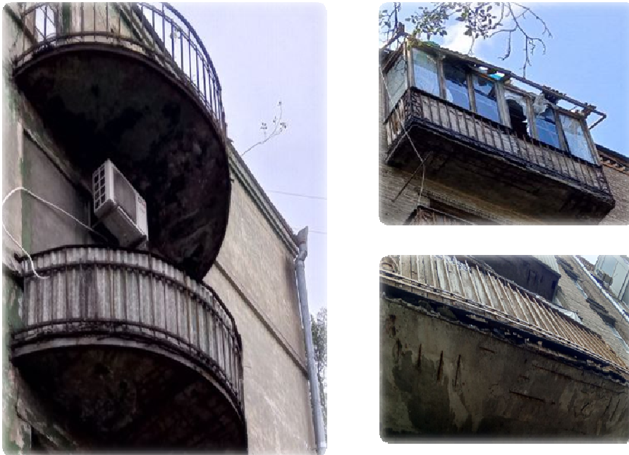
Рисунок. Дефекти плит балконів житлових будинків (сколи, тріщини, оголення та корозія арматури)
